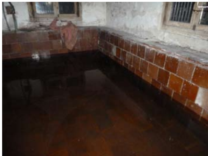
16.1 oude tegelvloer staat onder water
