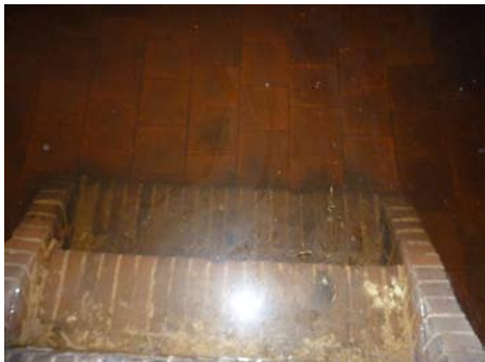
16.1 oude tegelvloer staat onder water
