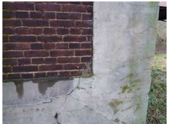
4.2 metselwerk, zettingen en scheuren
