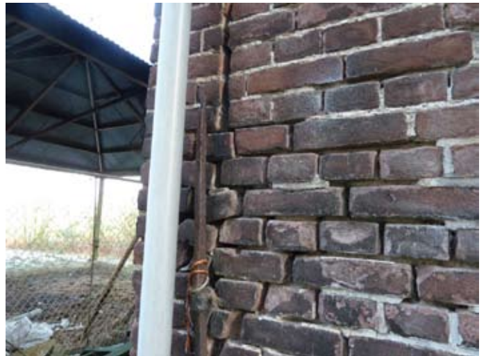
9.2 metselwerk zettingen en scheuren
