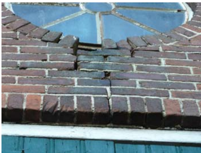
8.2 metselwerk, zettingen en scheuren
