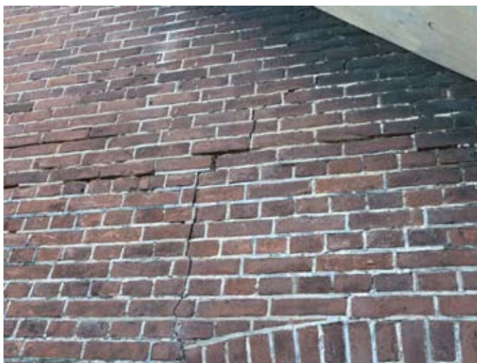
8.2 metselwerk, zettingen en scheuren
