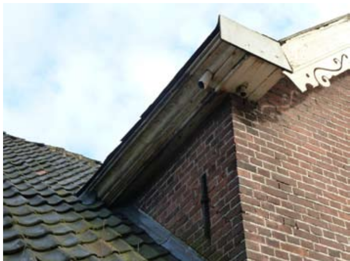
11.2 dakgoot, zuid-westzijde voorhuis
