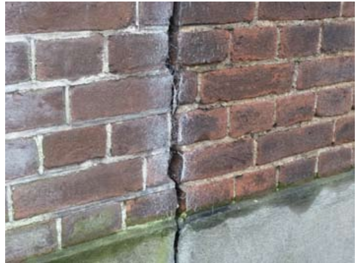
4.2 metselwerk, zettingen en scheuren
