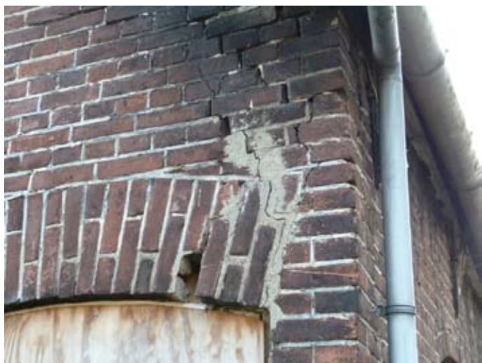
8.2 metselwerk, zettingen en scheuren
