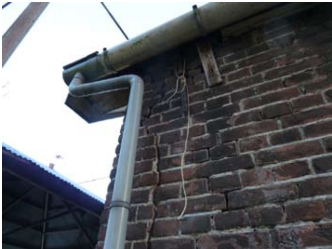
9.2 metselwerk zettingen en scheuren
