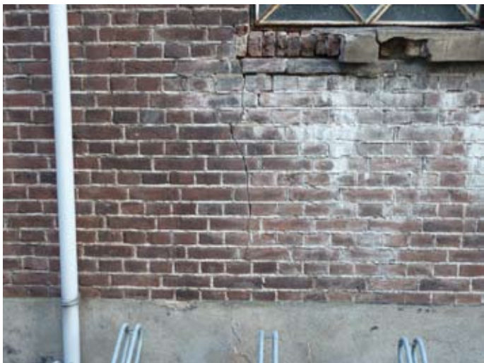
9.2 metselwerk zettingen en scheuren
