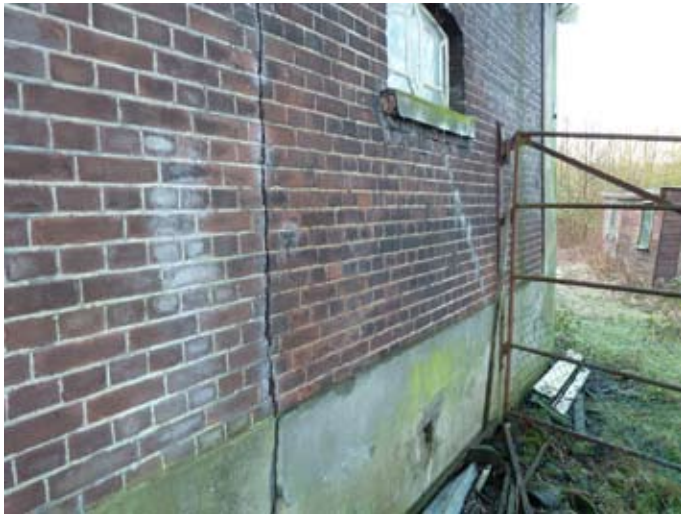
4.2 metselwerk, zettingen en scheuren
