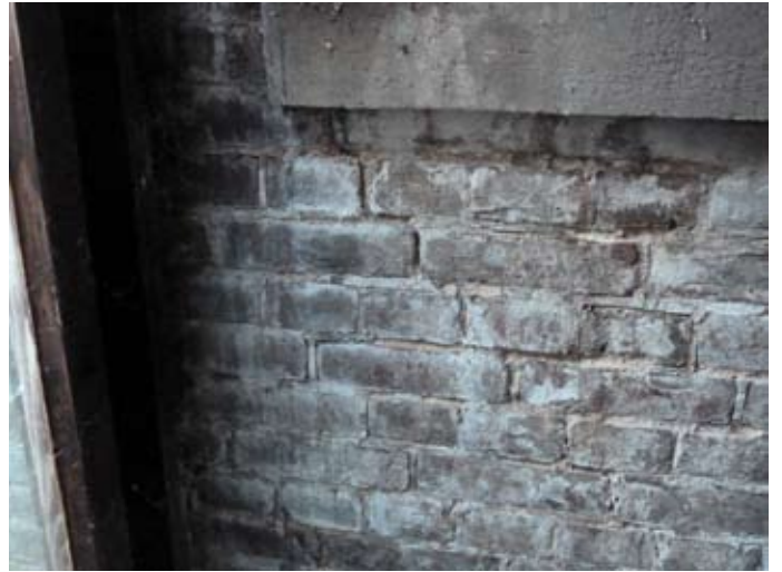
7.2 metselwerk, zettingen en scheuren
