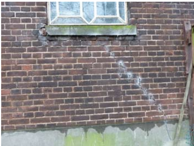
4.2 metselwerk, zettingen en scheuren
