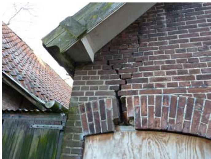
8.2 metselwerk, zettingen en scheuren
