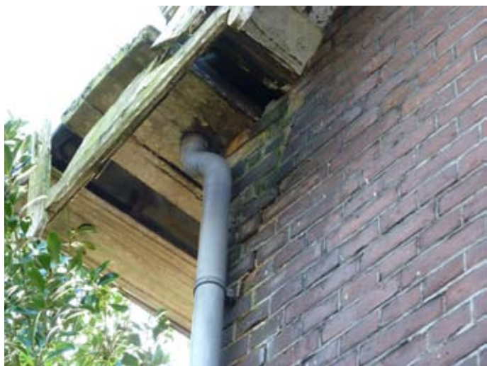
11.2 dakgoot, noord-oostzijde voorhuis
